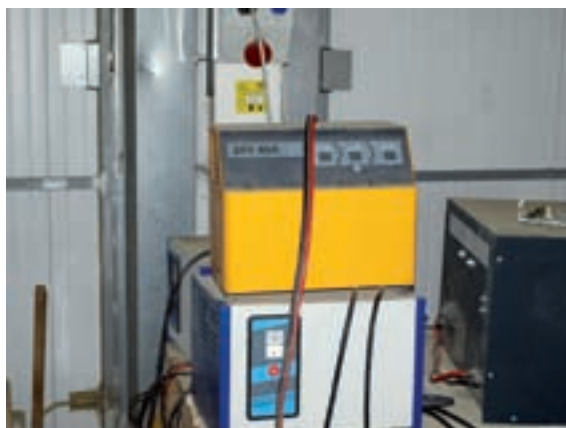
Detalle de cargador de baterías.
